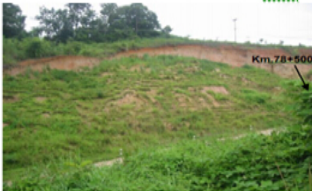
图 13 107 号公路，公路开挖斜坡地下水位高，有渗流，引发滑坡/泥土流（2005 年）
