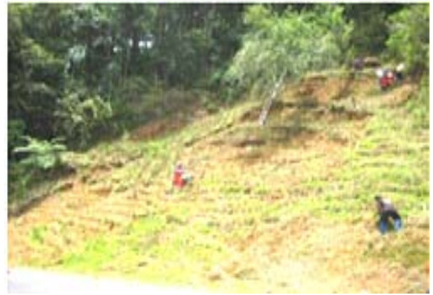
图 12 1240 号公路，应用香根草系统稳定山坡，防止土壤滑动.
