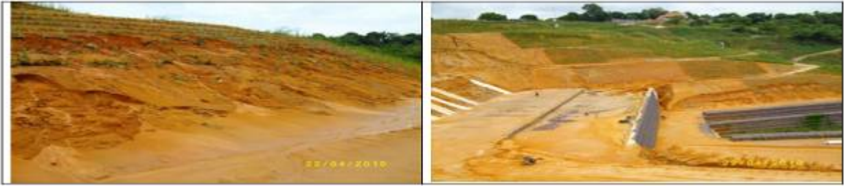
照片 11 (左)、12 (右): 由于香根草篱尚未长起, 坡面仍遭到侵蚀。
