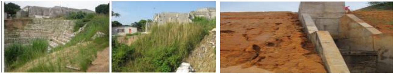
照片 8 (自左向右): 香根草种植后 2 个月 (地点 PYion, 2009 年 6 月); 照片 9: 香根草种植后 23 个月 (地点 PYion, 2011 年 5 月) 照片 10: 排水工程紧邻地带斜坡和路基堤坝的灾害情况 (2009 年 12 月)
