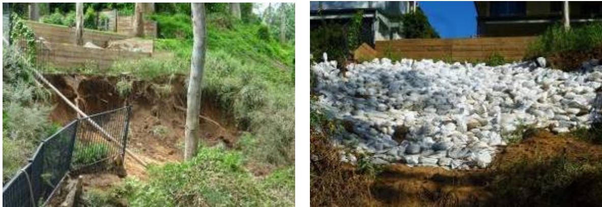
图 7 河岸受侵蚀, 房子和设施受到威胁 (左)。 蚀坑填以沙土包 (右)
